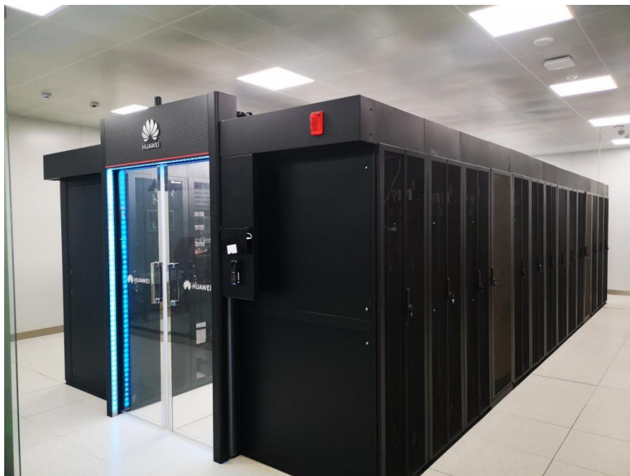
图 13：学校数据中心机房
